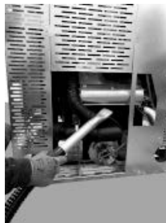
. 130 - Czyszczenie wentylatora pokojowego
