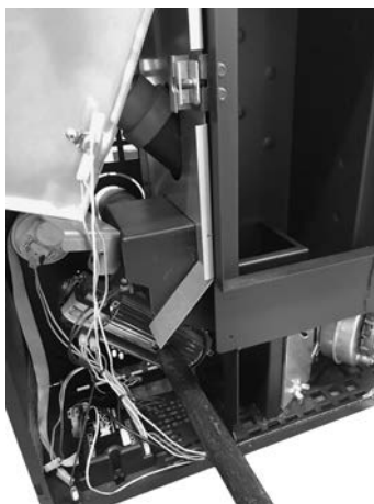
Fig. 69 - Czyszczenie wentylatora środowisko
